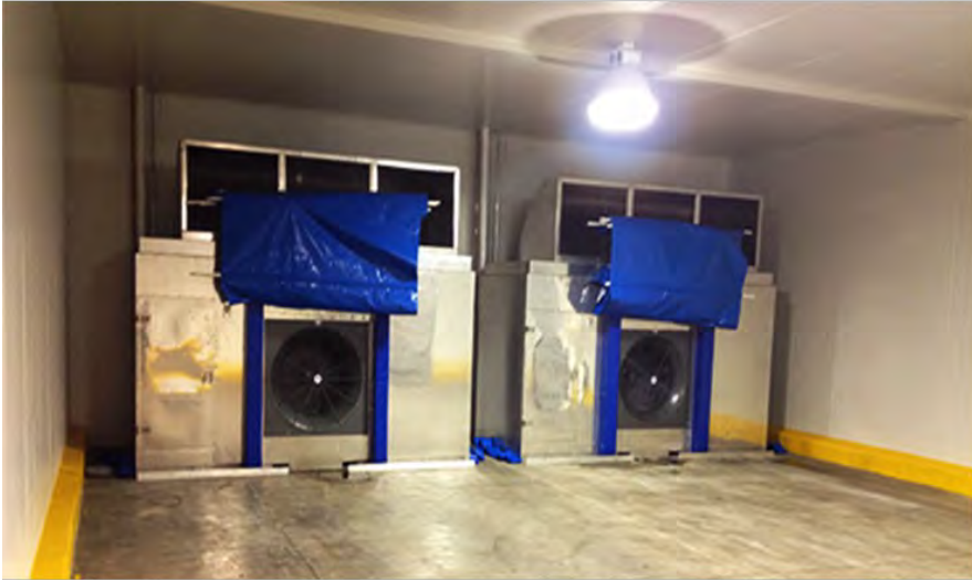
Cámaras de pre-enfriado
